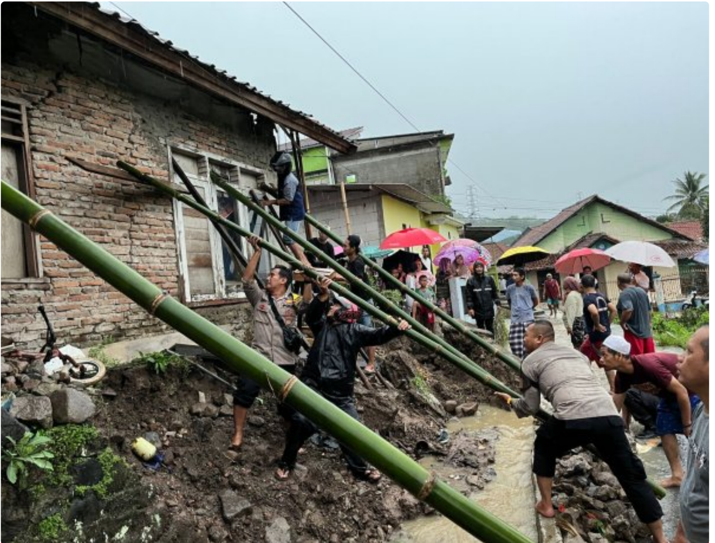
Polisi diPalabuhanratu Bantun Evakuasi Tembok Pagar Ambruk Akibat Hujan Deras, Rumah Warga di Desa Citarik Rusak
